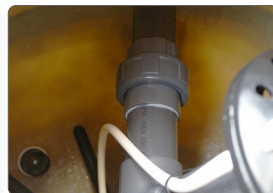
Bocchettone di manutenzione interno.
