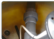
Bocchettone di manutenzione interno.
